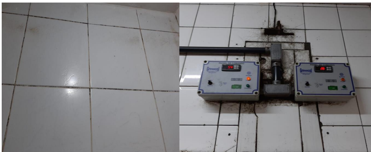
Figura 21. Pontos de sujeira na câmara fria da unidade
